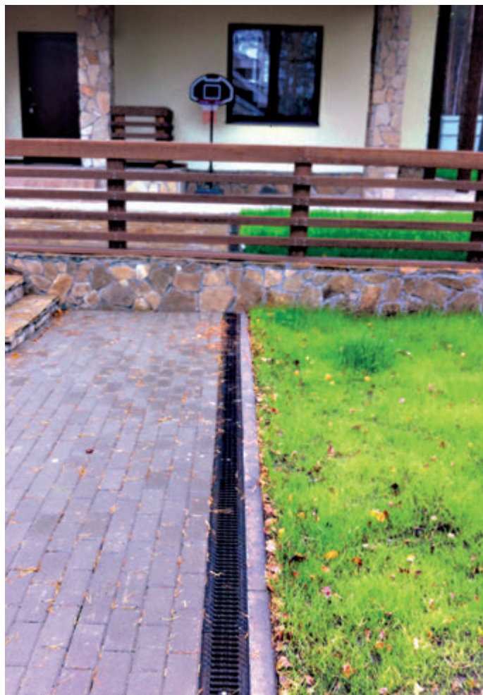
г. Екатеринбург, коттеджный поселок «Галактика», водоотводные лотки Hidrolica® Standart с чугунными решетками
