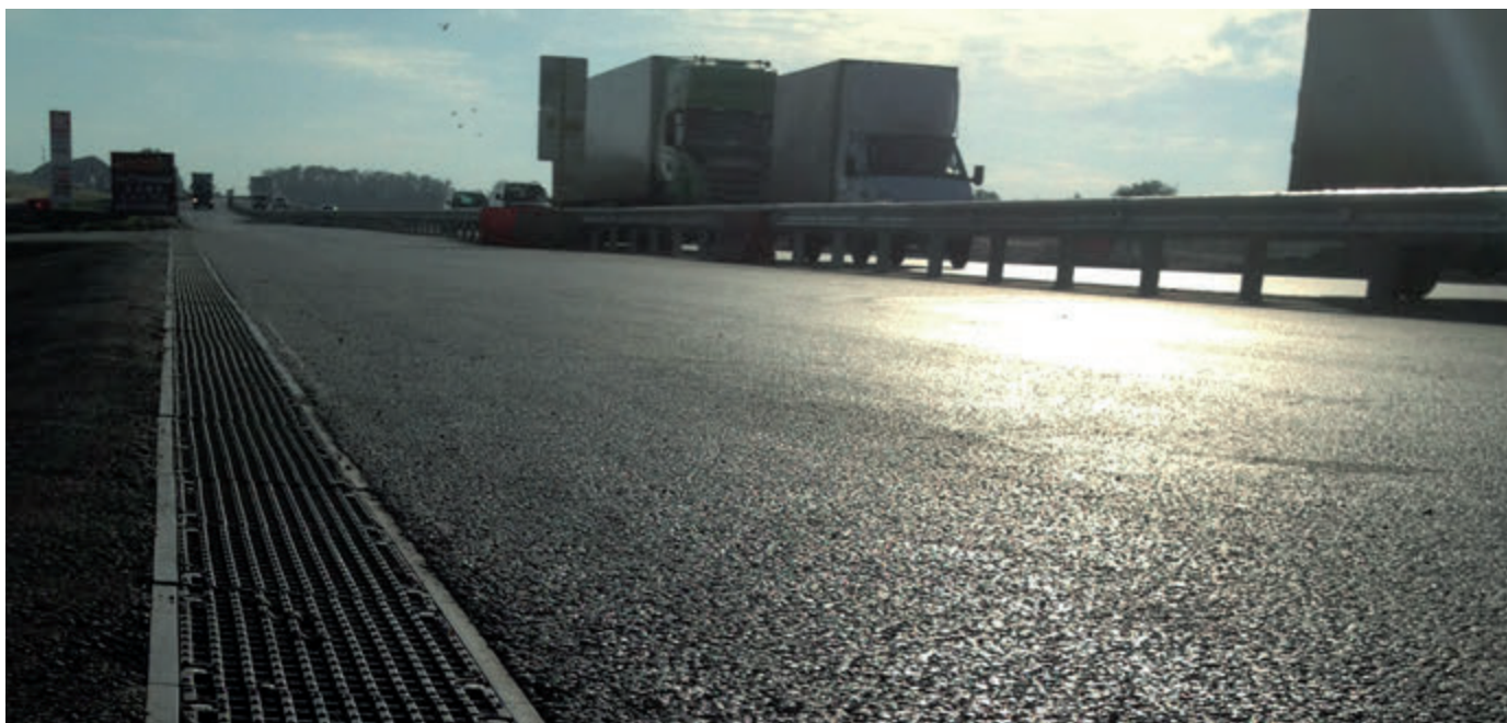
Трасса Дон, Кореновск, водоотводные лотки BGZ-S с чугунными решетками
