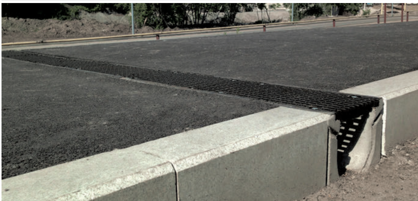
г. Новосибирск, мост через р. Обь, развязка, водоотводные лотки BGZ-S с чугунными решетками
