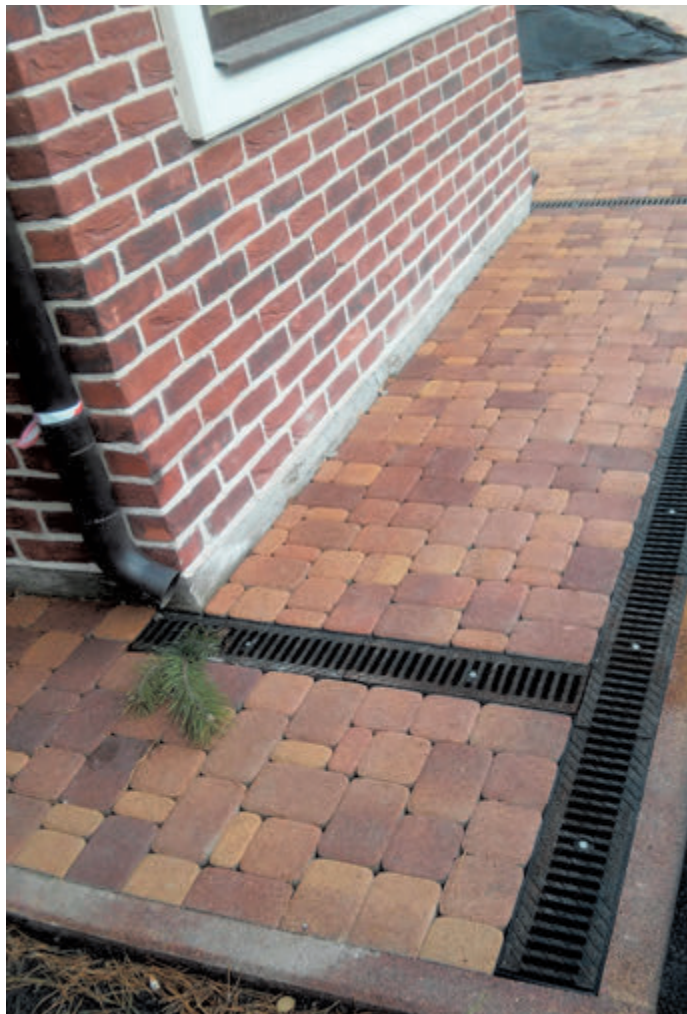
Частный дом, водоотводные лотки Gidrolica® Standart с чугунными решетками
