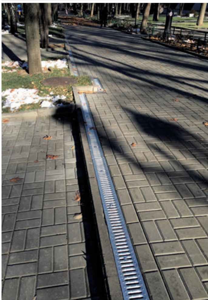
г. Москва, Бабушкинский парк, водоотводные лотки Hidrolica® Standart с оцинкованными решетками
