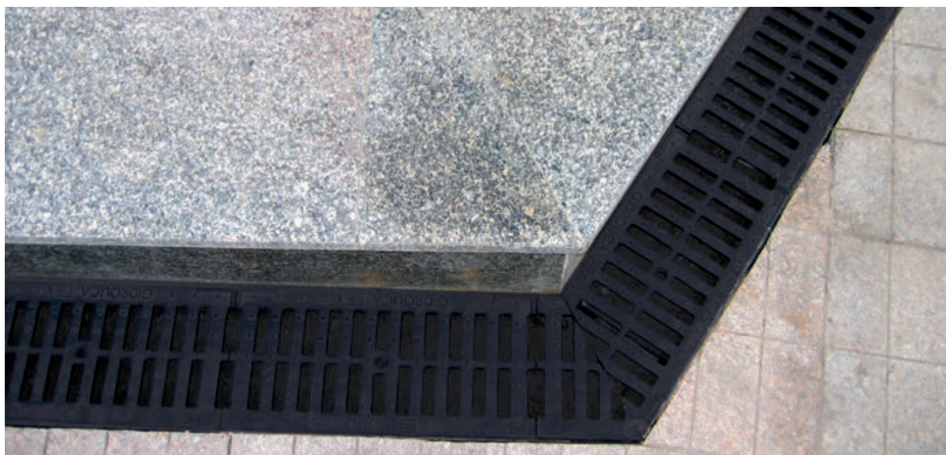
На улицах города, водоотводные лотки BGU с чугунными решетками
